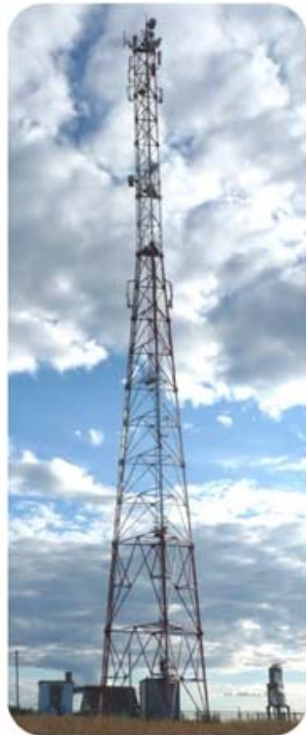
Общий вид сайта BTS энергопотребление около 5 кВт
